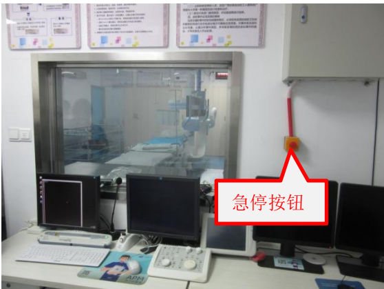
图 3-6 控制室操作台及急停按钮（介入 1 室）
