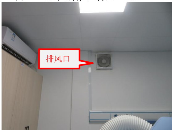
图 3-13 南侧墙面排风口（介入 1 室）
