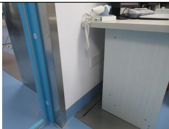
图 3-16 控制室线孔（介入 1 室）
