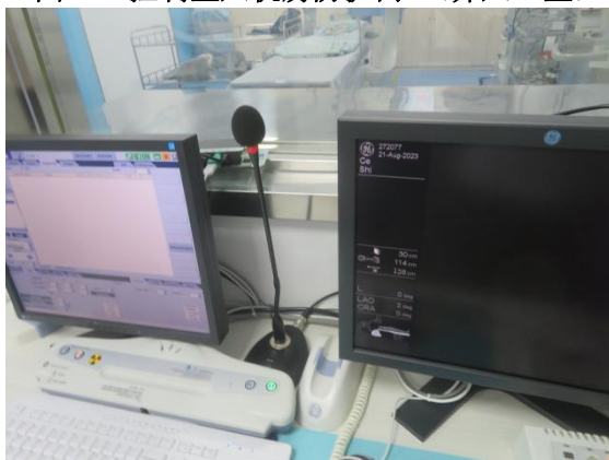
图 3-9 对讲装置（DSA 控制室内）
