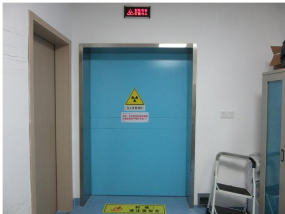
图 3-5 病人出入机房防护门（介入 1 室）
