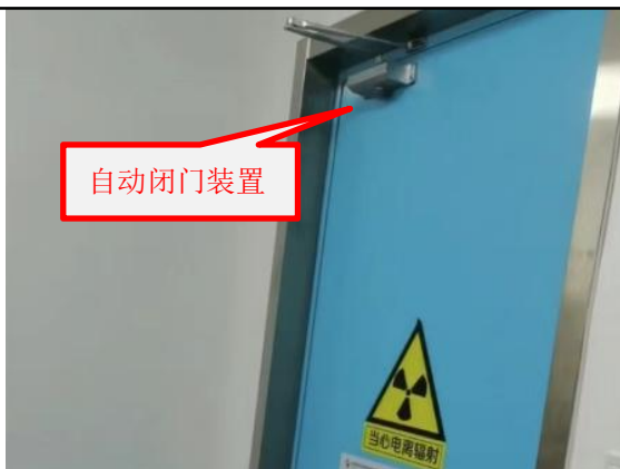
图 3-7 控制室入机房防护门（介入 1 室）
