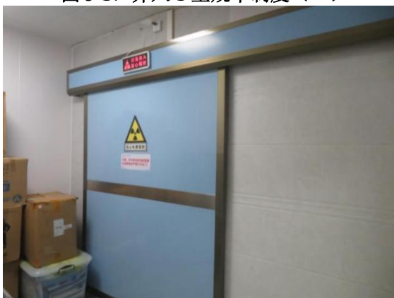
图 3-19 病人出入机房防护门（介入 2 室）
