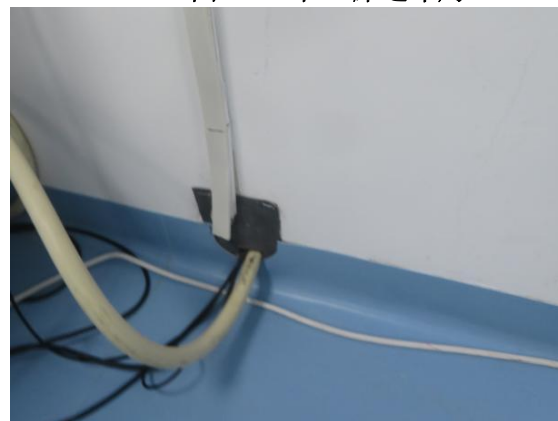
图 3-26 控制室线孔（介入 2 室）
